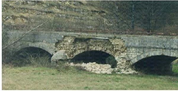
ekil 2. Köprüde meydana gelen hasar [7]
