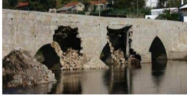
ekil 1. D. Zameiro Tarihi Köprüsünde oluşan hasarlar [5]
