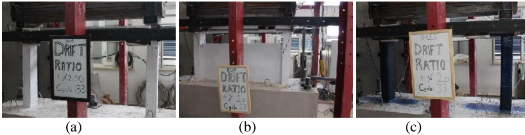
ekil 5. %2 Görelî kat ötelemesi oranında (a) CFRPE_01 (b) CFRPE_02 (c) CFRPE_03 hasar durumları
