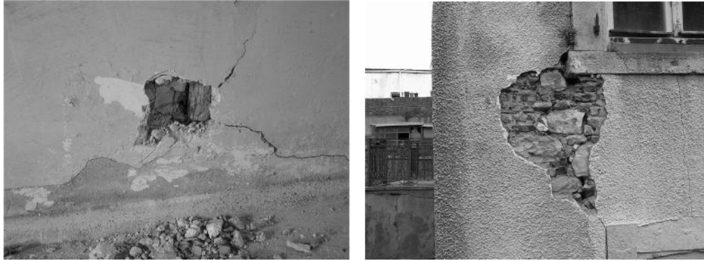
ekil 5. ncelenmekte olan binada a) dı , b) iç duvarlarda tespit edilen çatlaklar ve bozulmalar
